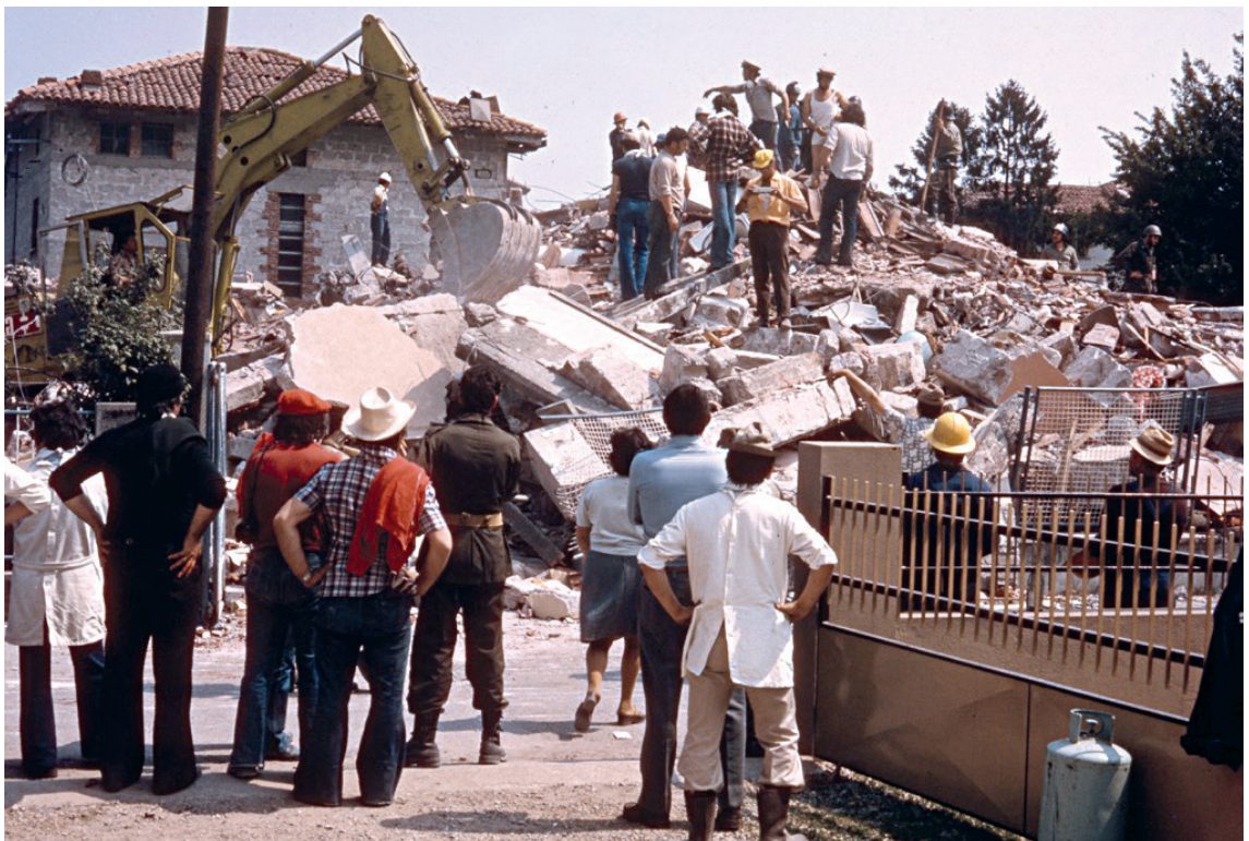
Fig. 2 - Si scava tra le macerie (fotografia di Adriano Scotti).
