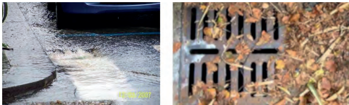
Fig. 3 - La manutenzione delle caditoie stradali condiziona la loro efficacia.
